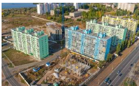
Объект: ЖК «Волжский изумруд», г. Энгельс, ул. Студенческая Поставщик: ООО «Сантехкомплект»
